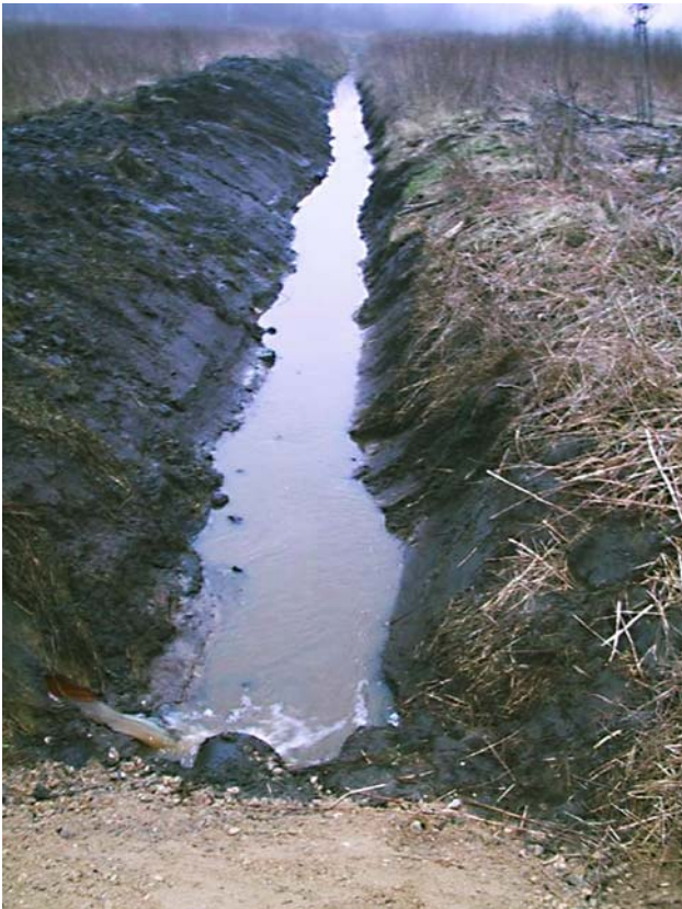
Figur 4. Sikring af fri passage for overskydende vand kan have alvorlige konsekvenser for planterne i en grøft. Foto: Nina Cedergren
